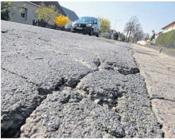
Kaputt: Die Jöllenbecker Straße müsste dringend saniert werden. FOTO: ANDREAS SUNDERMEIER
