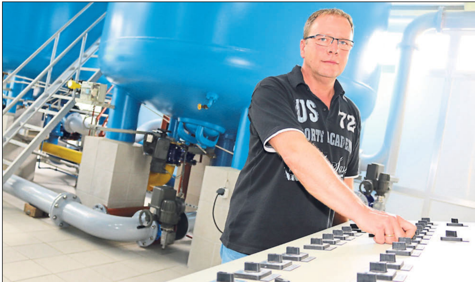
Wassermeister Matthias Kehlenbrink in der Wasseraufbereitungsanlage des EWB-Wasserwerkes Ahle. Die EWB ist zuständig für die Trinkwasserversorgung von etwa 26 500 Haushalten in Bünde, Kirchlegern und Rödinghausen. Foto: Hilko Raske
